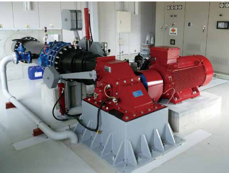
水車・発電機（定格出力136kW）
